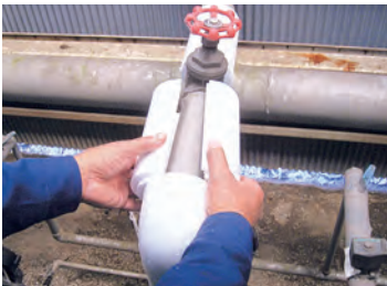
パイプカバー(配管断熱)
