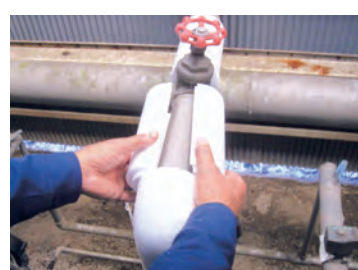
パイプカバー(配管断熱)
